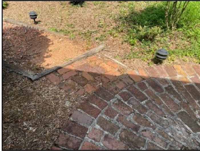
19. Uneven (trip hazard)
