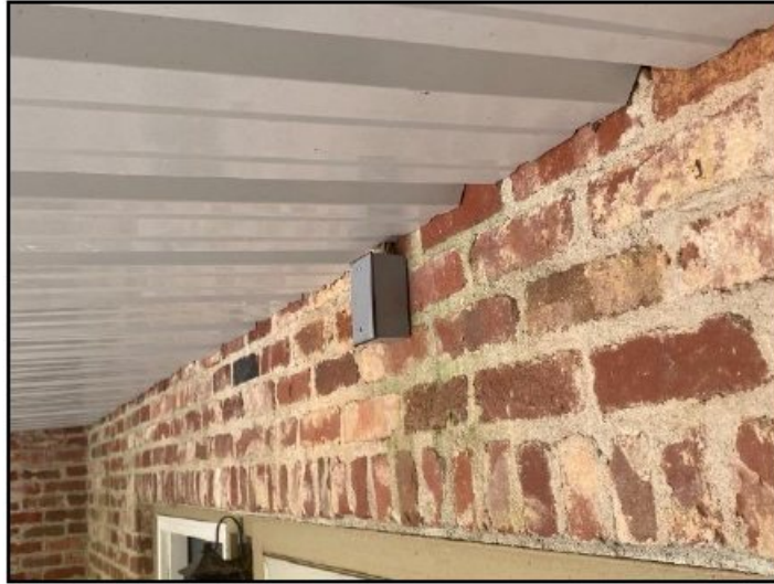
36. Flexible conduit needed
